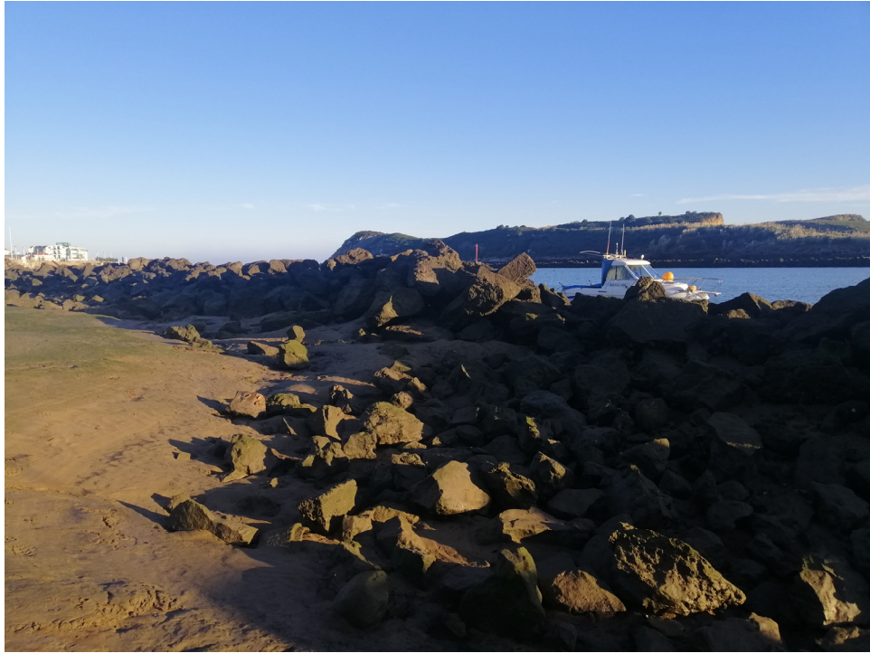
Tramo pk 80: situación actual de la escollera en la parte interior, lado opuesto a la ría
